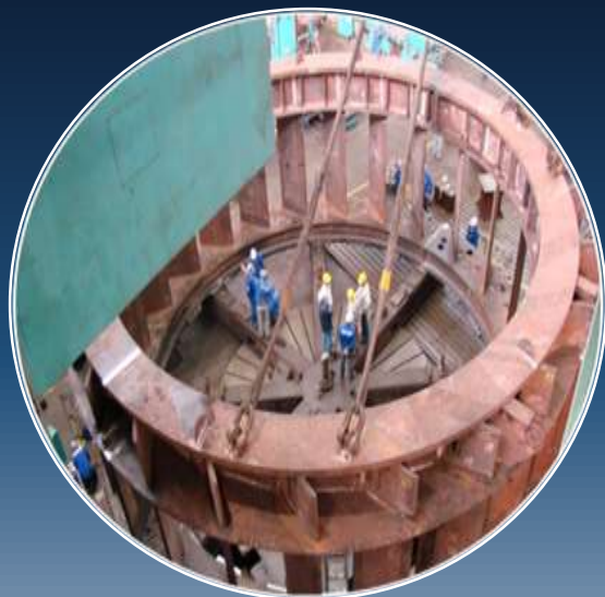
Pré-distribuidores Hidrelétrica – IMPSA
