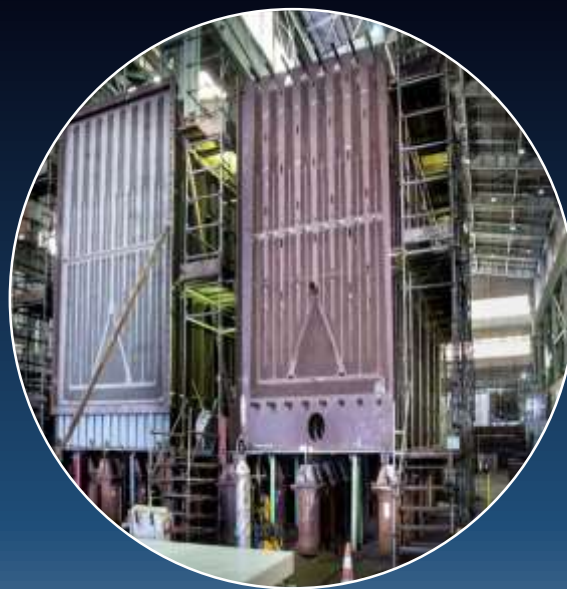
Condensadores Angra II
