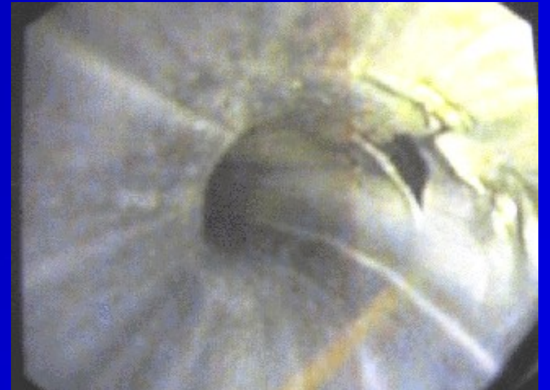
Inspección Visual en tubo de acero inoxidable
